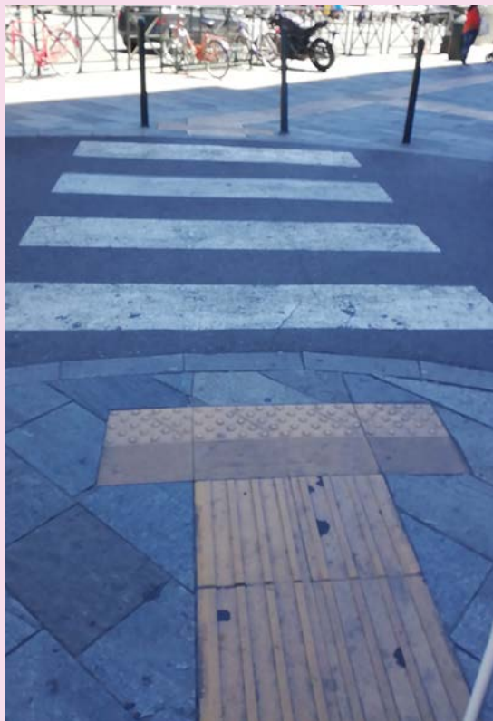
FOTO 10. Perfetto passaggio pedonale “a raso” senza nessun gradino. Perfetto per i disabili motori ma pericoloso per i disabili sensoriali in quanto senza segnalazione LOGES di pericolo valicabile “prima” di entrare sul sempre pericoloso passaggio pedonale.
